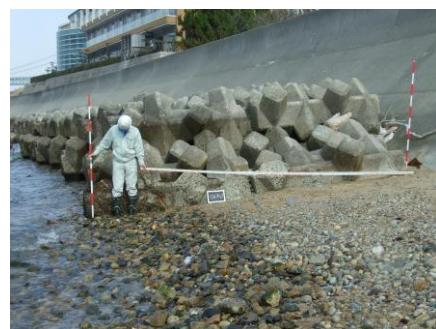
写真1 根固めコンクリートブロックと海水面 (2021年4月2日14時50分撮影)
