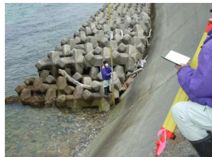
写真2 根固めコンクリートブロックと海水面 (2022年3月23日11時00分撮影)
